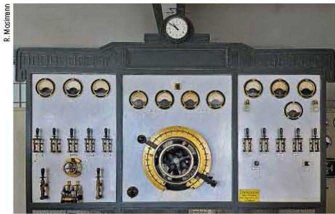
Bild 2 Alte Schalttafel im historischen Kleinkraftwerk Ottenbach (um 1910).
